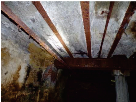
Bild 29: Keller mit verschimmelter Kappendecke
