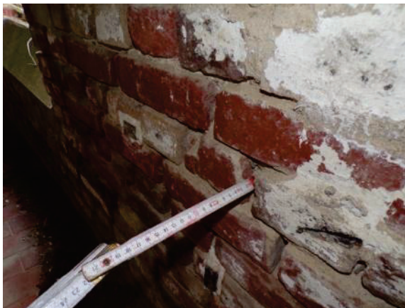
Bild 17: Mauerspalte, Tiefe ca. 5 cm
