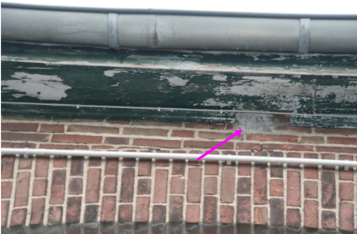
Abb. 10: alter Traufkasten mit spaltenförmiger Öffnung und (Kot?-) Spuren
