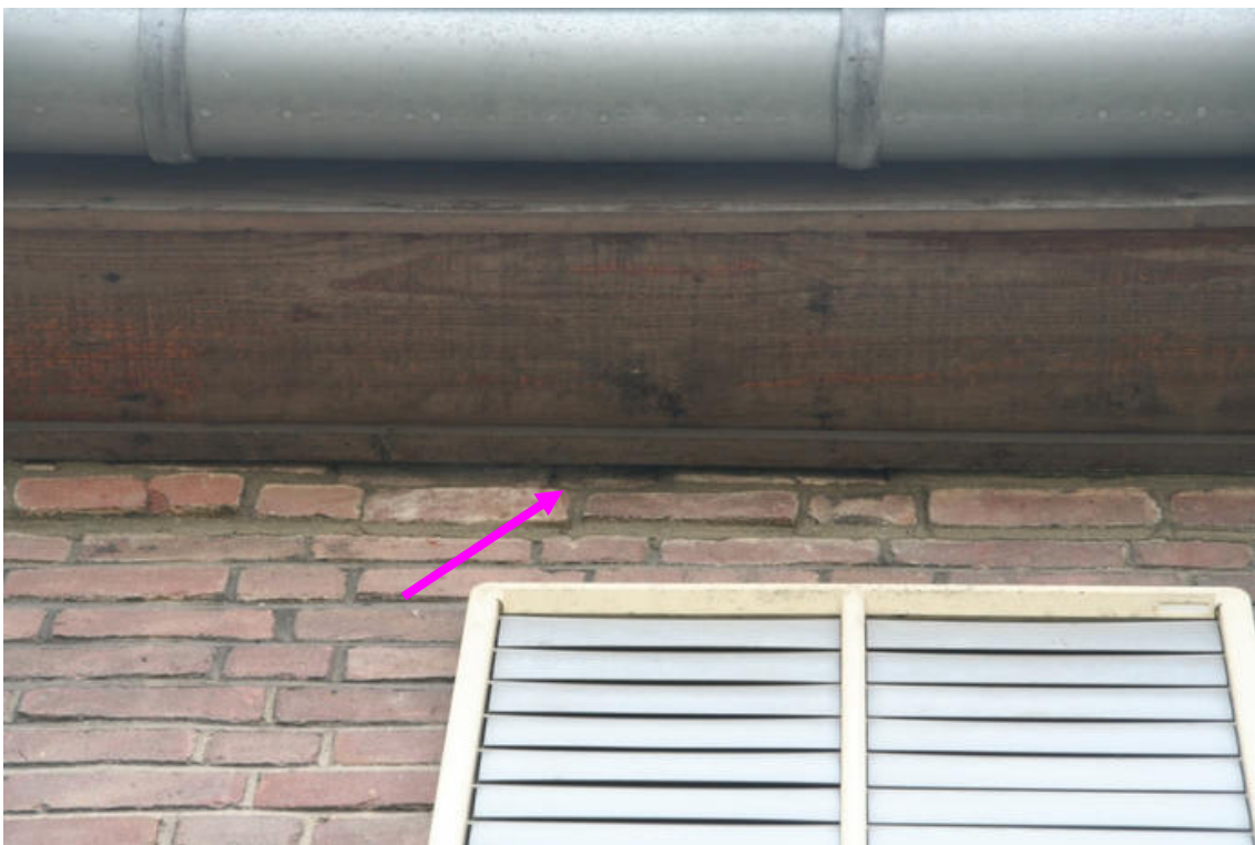
Abb. 18: Traufkasten mit Spalt, potenzielles Fledermausquartier
