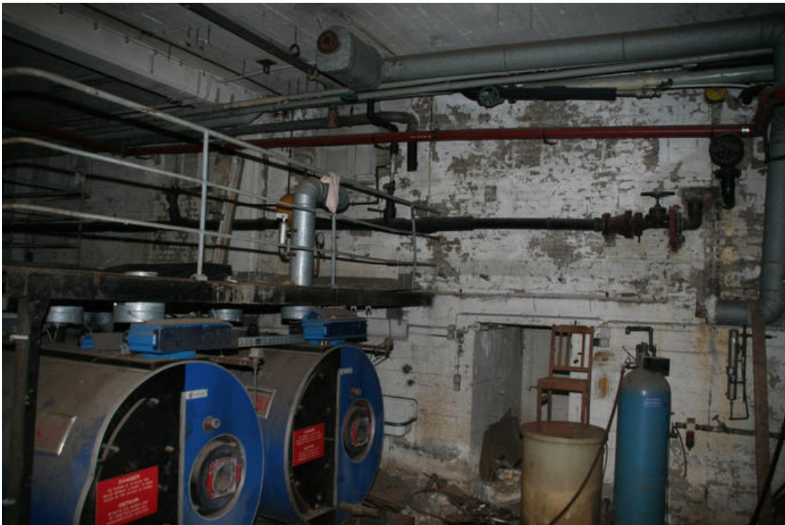
Abb. 20: Heizungskeller des Nordgeländes
