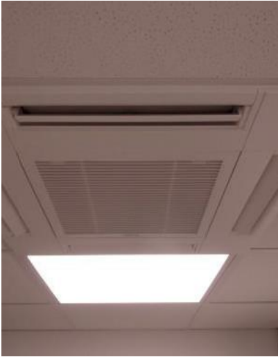
Deckenkassette mit Wärmepumpe
